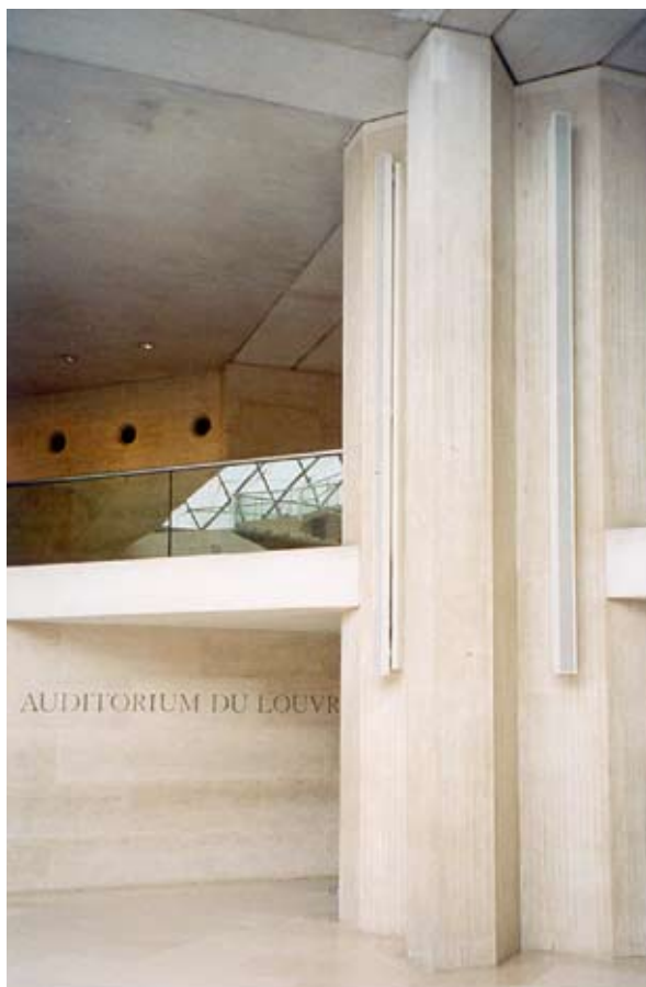
Colonnes Intellivox de DURAN AUDIO installées dans le hall du musée du Louvre à Paris
