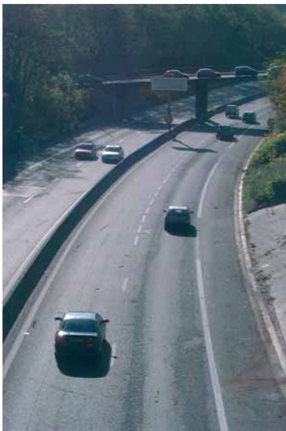
Photo 8 : Dégradation des enrobés drainants sur une voie rapide
