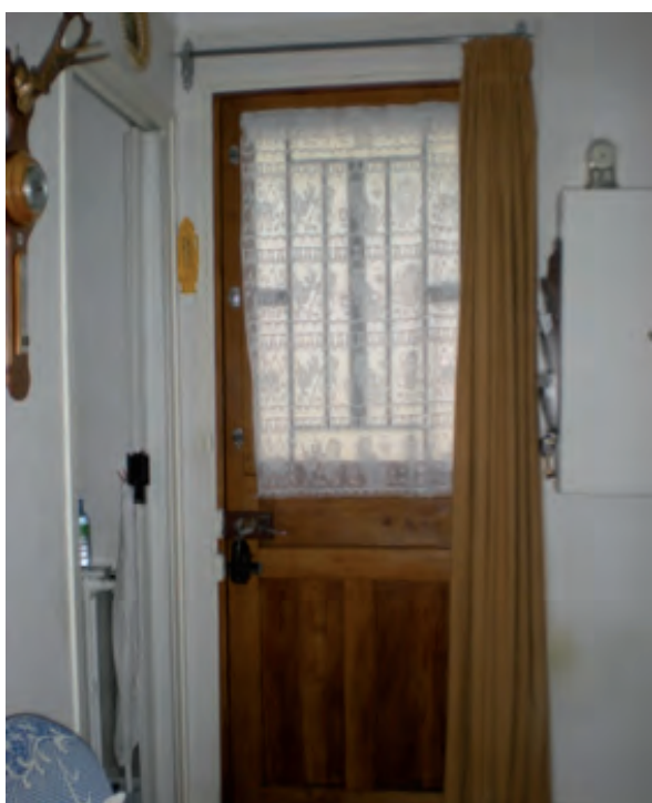
Fig 5 : La porte d'entrée du pavillon qui donne sur une pièce principale présente un isolement limité
