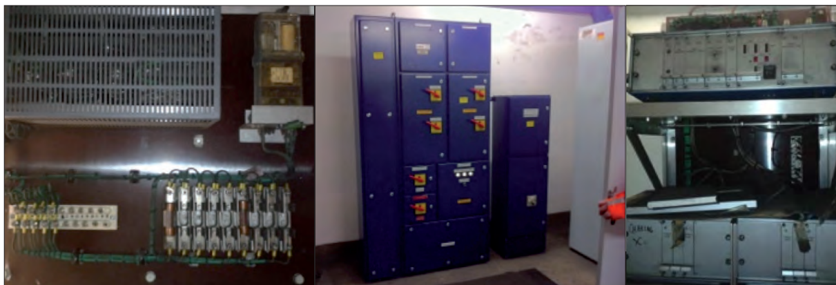
Fig. 5 : Exemple d'équipements sensibles présents dans les switch rooms
