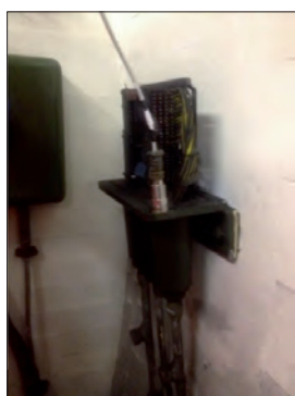
Fig. 6 : Exemple de montages des accéléromètres sur les équipements sensibles
