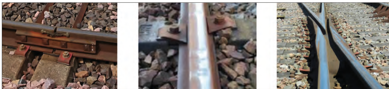
Fig. 2 : Exemples de points singuliers source de bruit. Joint de rail éclissé (gauche). Défauts de type squat (centre). Cœur de croisement (droite). Examples of singular points source of noise.
